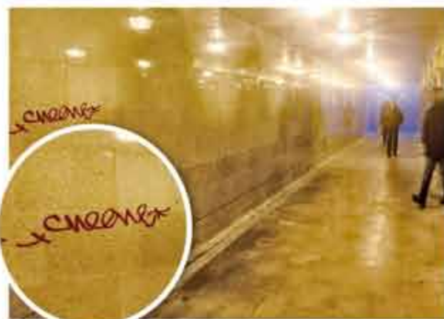
Надпись на стене подземного перехода сделали через неделю после открытия
